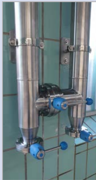
Abgang Wasserleitung DN80 zur Enthärtungsanlage
