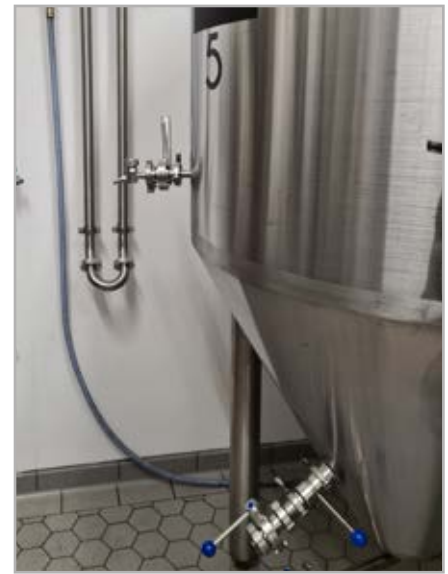
Knapp 20 Meter Getränkeleitungsrohr in Größe DN32 führen vom Sudhaus in den Gärkeller der SägerBräu.
