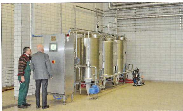
Die neue CIP-Anlage im Kellerabteil 1 (Fotos: Heinrich Leicht GmbH & Co. KG)
