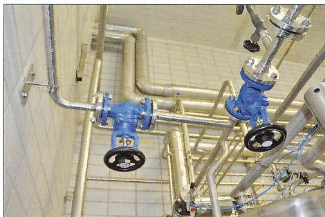
Dampf und Kondensat für CIP und Keller 1
